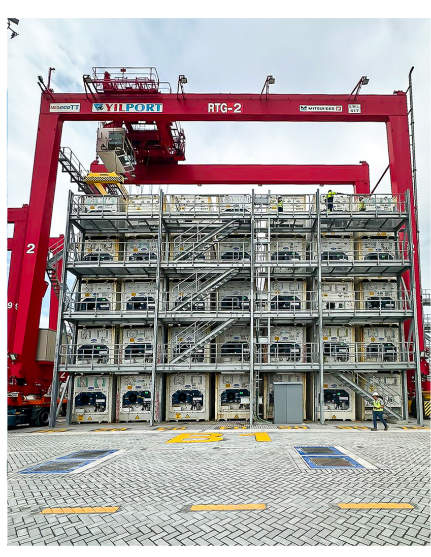
Tomas refrigeradas en YILPORT Puerto Bolívar
